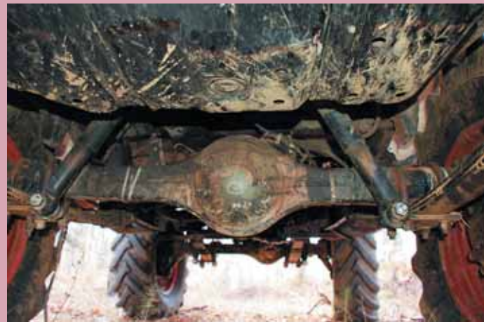
Наварка площадок да устройство новых креплений рессор на раме. Кстати, задний мост — это третий у трехосника Volvo C303. Редуктор, как видно, расположен по центру, а у двухосника он справа — удобнее для тойотовской «раздатки»
